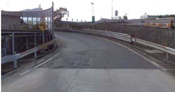
舗装損傷状況
