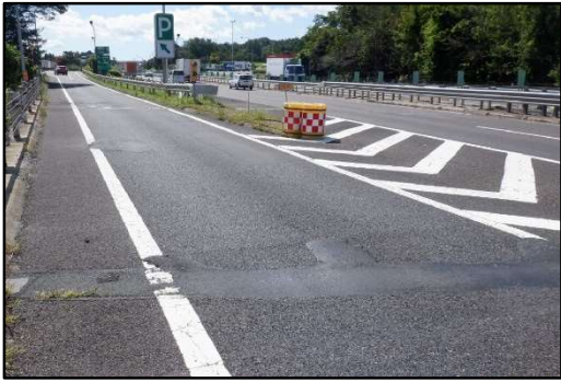
舗装損傷状況
