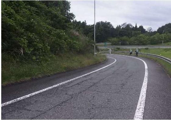
舗装損傷写真
