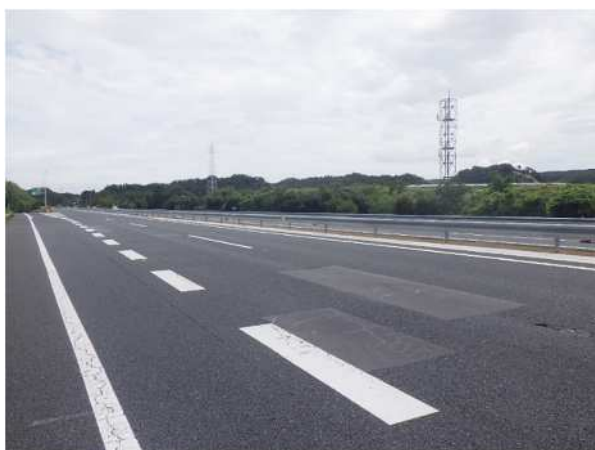
舗装損傷状況
