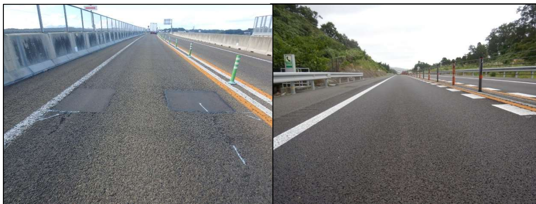
舗装損傷写真
