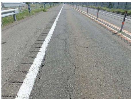
舗装損傷写真
