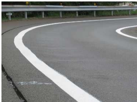
舗装損傷状況
