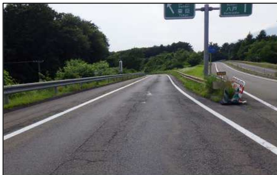
舗装損傷状況
