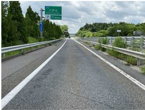
舗装損傷写真
