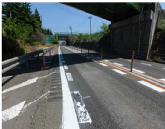
舗装損傷写真
