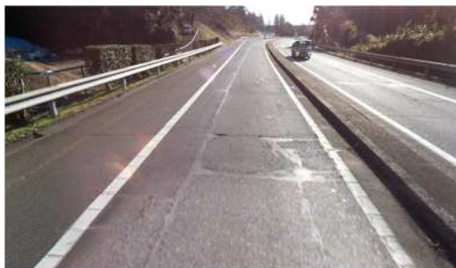
路面損傷状況
