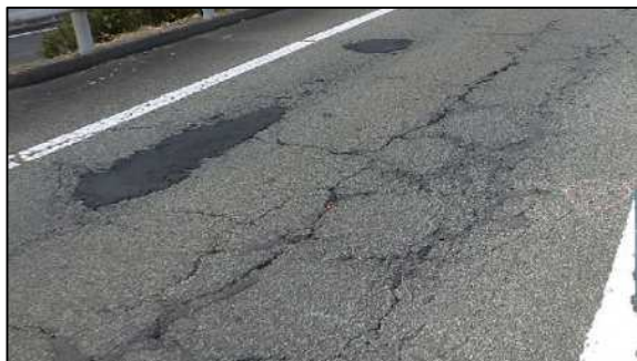
舗装損傷状況
