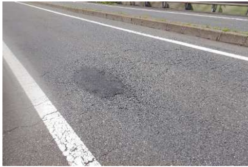
舗装損傷状況
