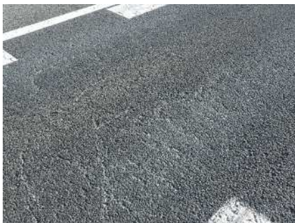
路面損傷状況
