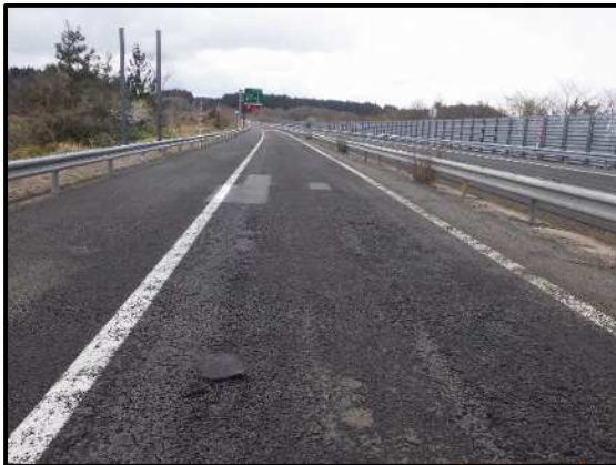
舗装損傷写真
