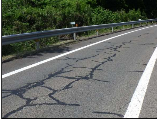
舗装損傷状況
