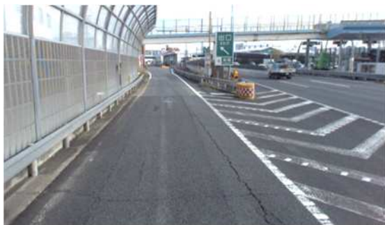
路面損傷状況
