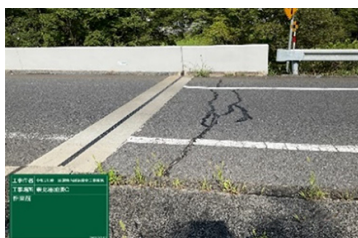
加須IC舗装損傷状況
