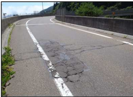
舗装損傷状況
