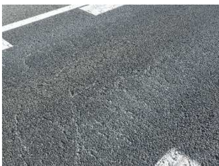
路面損傷状況
