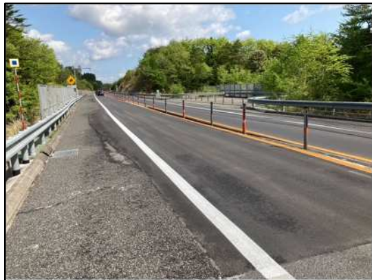
舗装損傷写真
