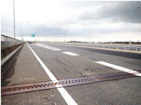
舗装損傷状況
