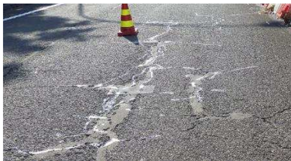
舗装損傷状況
