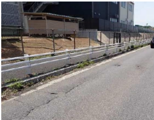
舗装損傷状況
