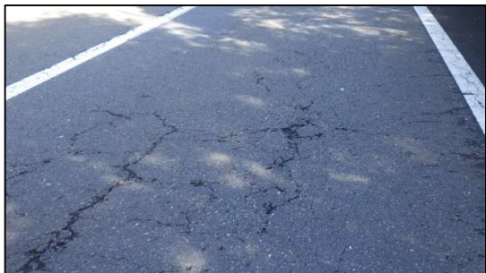
舗装損傷状況
