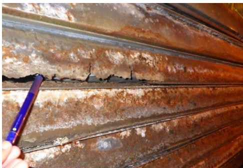
遮音壁損傷状況
