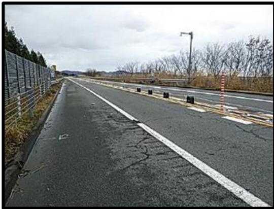
舗装損傷写真
