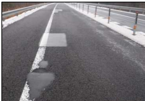
舗装損傷写真
