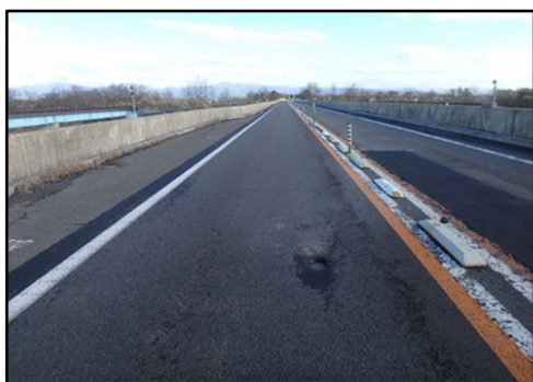
舗装損傷写真
