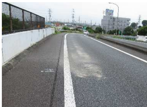
舗装損傷状況
