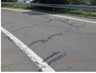
宇都宮ICランプ 舗装損傷状況
