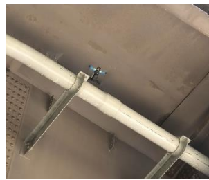
狭隘部での変状確認
