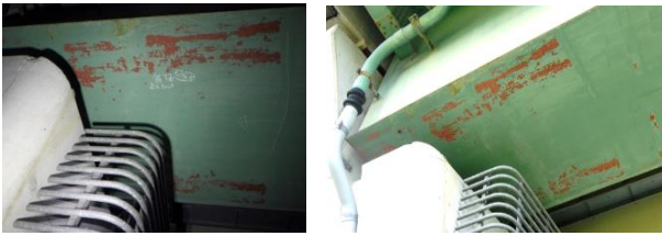
塗膜劣化 (左: 近接目視 右: ドローン)
