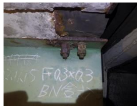
ボルト腐食 (左: 近接目視 右: ドローン)
