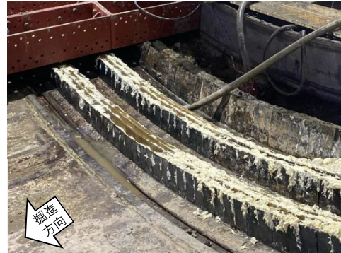
写真. テールシール(交換後)
