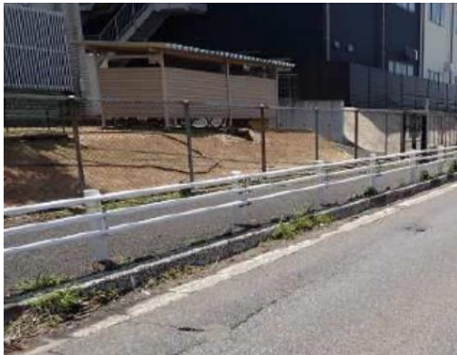
舗装損傷状況
