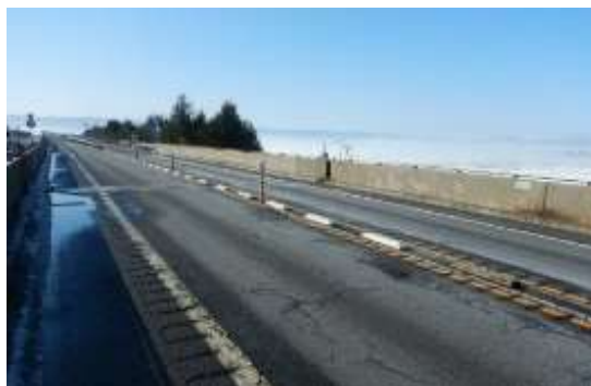
損傷した路面状況
