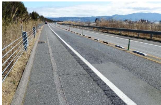
損傷した路面状況
