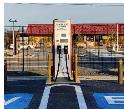
写真-2 150kW 級 EV 急速充電器 (E1A 伊勢湾岸道 湾岸長島 PA(上り線))
