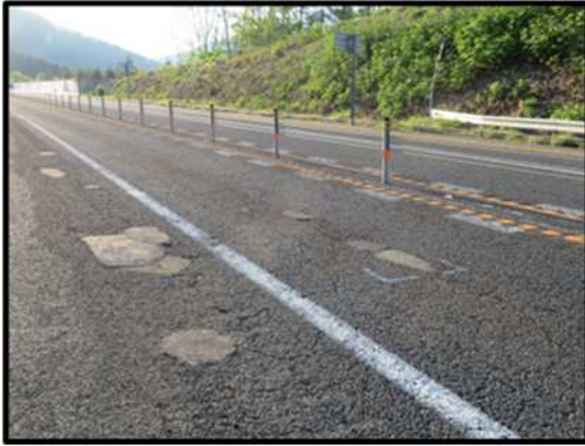
舗装損傷写真
