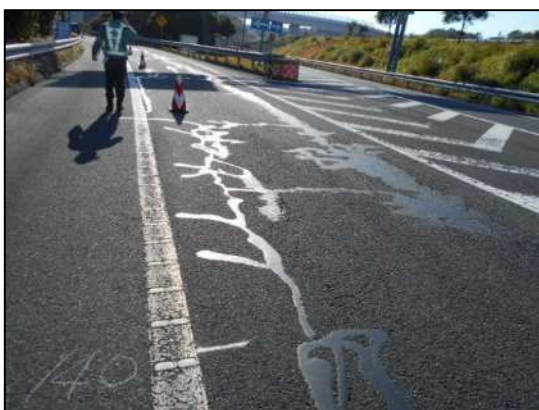
舗装損傷写真
