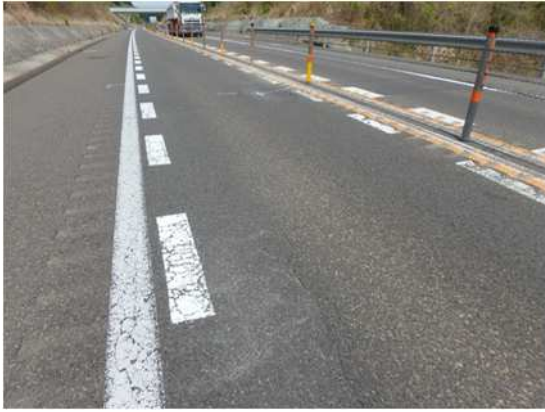
舗装損傷写真
