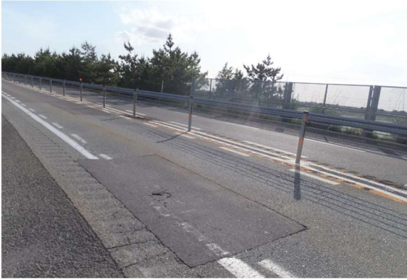
損傷した路面状況
