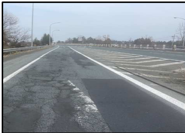
舗装部損傷写真
