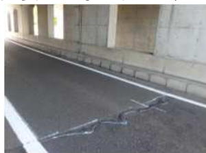
舗装損傷現況
