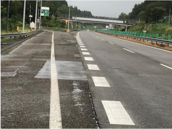
損傷した路面状況(中郷IC)
