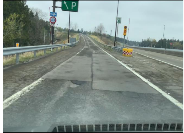
損傷した路面状況(妙高SA)
