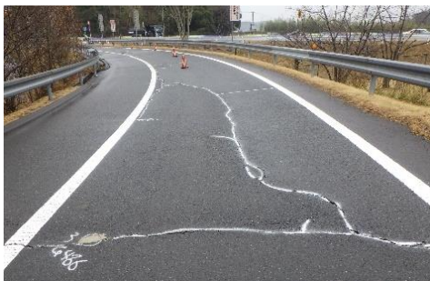
舗装損傷状況
