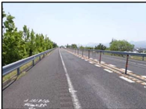
舗装損傷写真
