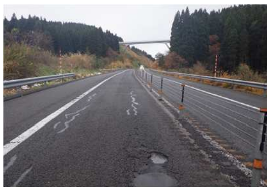
舗装損傷写真
