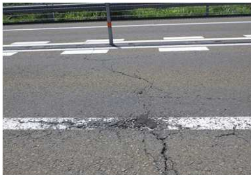
舗装損傷写真
