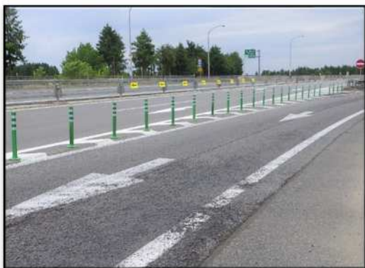
舗装損傷写真
