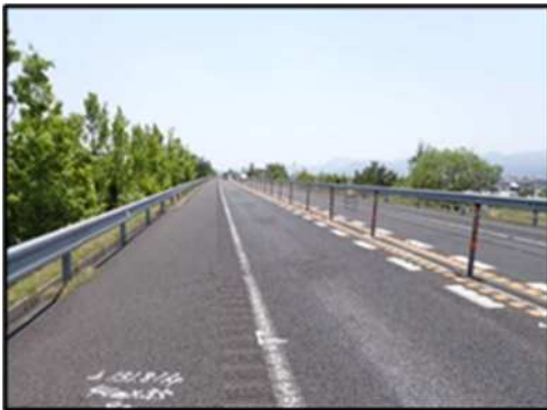
舗装損傷写真
