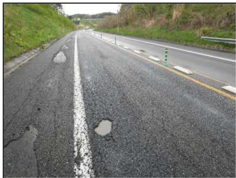
舗装損傷写真
